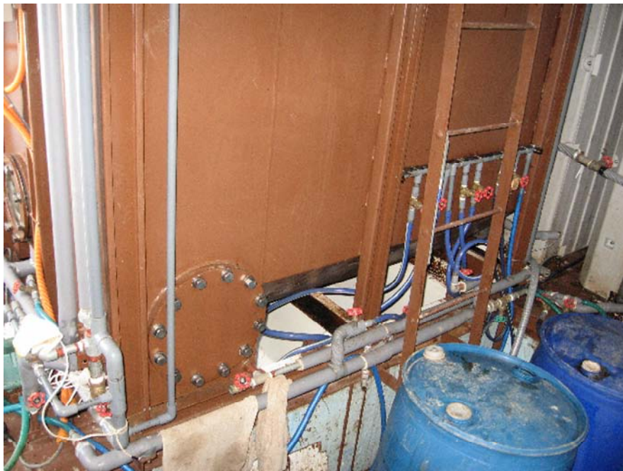
写真2 実証対象装置(処理設備:下部発酵槽、上部発酵合成槽)
