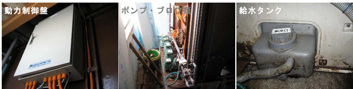
写真3 実証対象装置(各処理設備)
